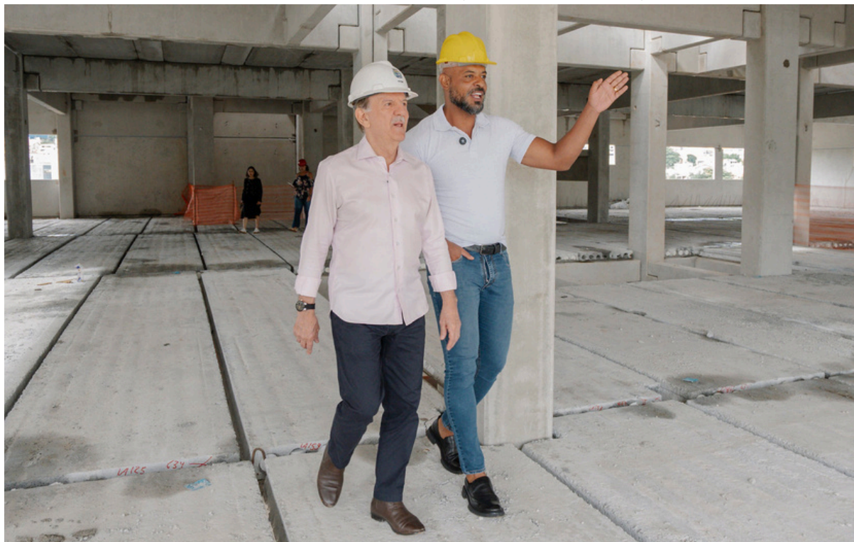
Prefeito Beto Piteri e o vereador Thiago Rodrigues acompanham o avanço das obras da nova maternidade, que vai ampliar e qualificar o atendimento às gestantes
